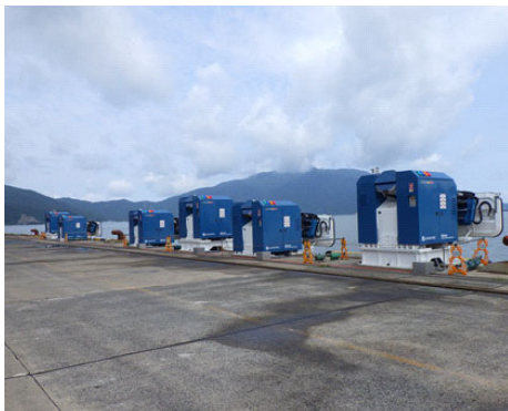
敦賀港の自動係留装置（全6基）
