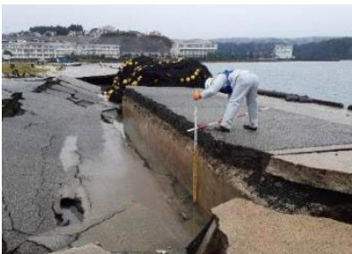
物揚場エプロン沈下
