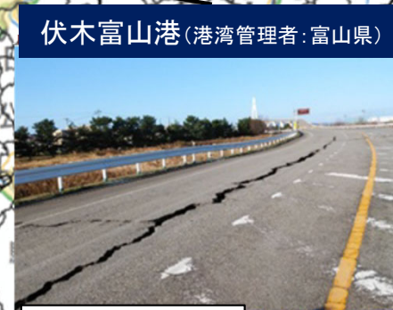
臨港道路の亀裂
