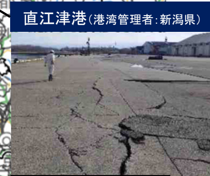
ふ頭用地の亀裂・段差
