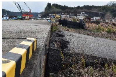
物揚場エプロンの段差
