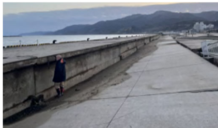
岸壁背後沈下
