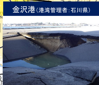
ふ頭用地の陥没
