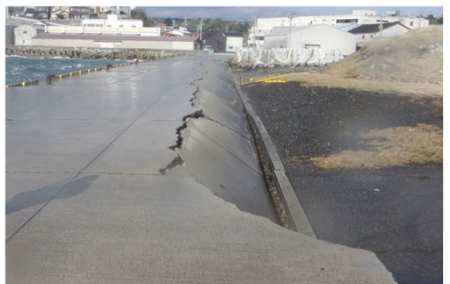
岸壁エプロンの段差
