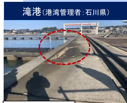
エプロンの陥没
