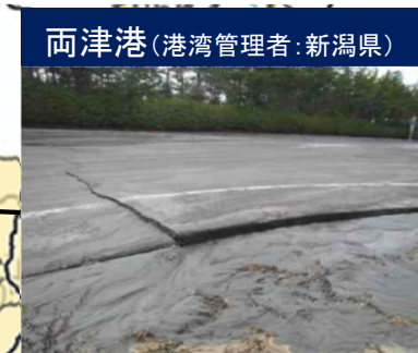
臨港道路の液状化
