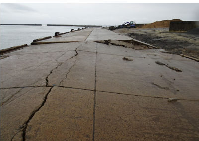
岸壁エプロン沈下
