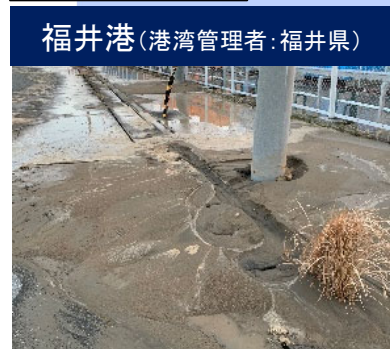
臨港道路の液状化
