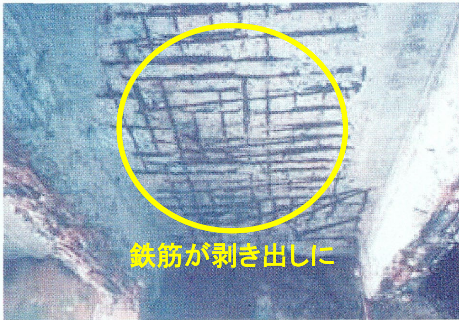
栈橋上部工の劣化事例
