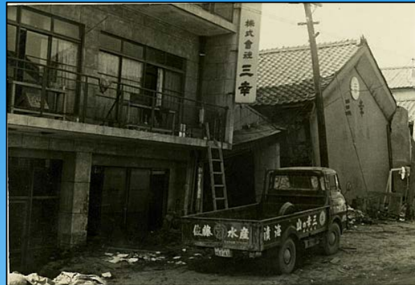
地盤沈下した建築物
