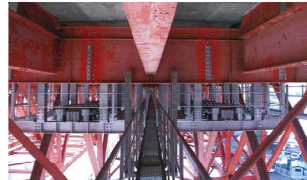
写真-2.1 TMD 設置例 (トラス橋)
