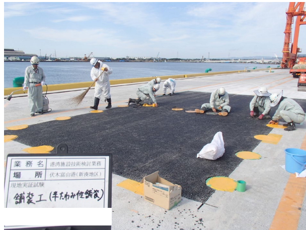
写真 4.16 半たわみ性舗装敷設前状況（伏木富山港における施工例）
